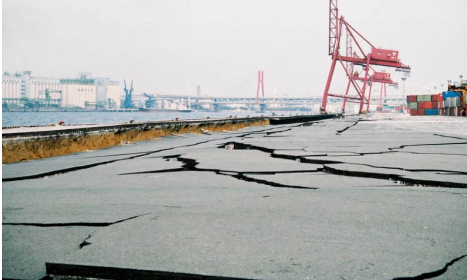
1995年兵庫県南部地震による神戸港のケーソン式岸壁の被害
